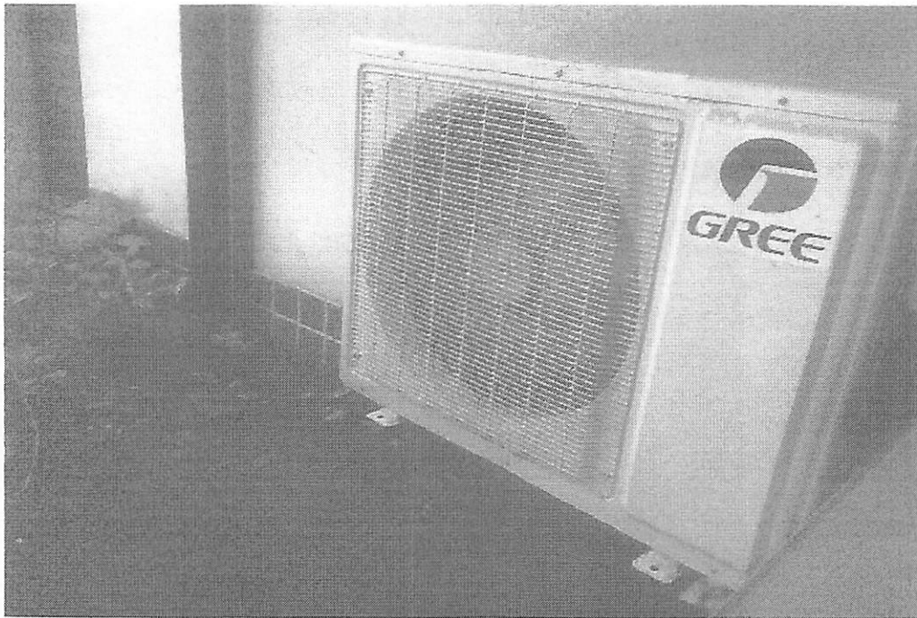
Unidade condensadora split 18000 BTUS marca GREE
